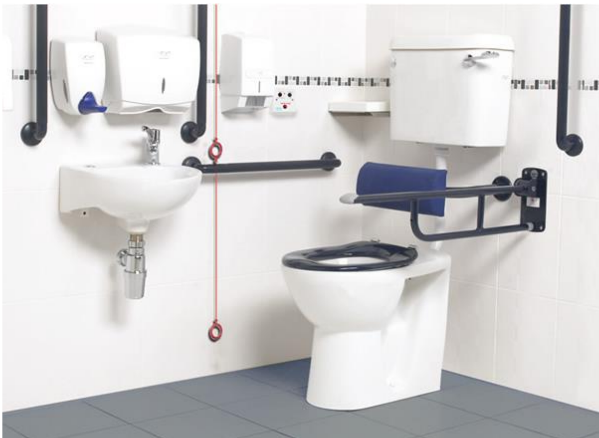
चित्र 14: दो स्तरों पर आपातकालीन अलार्म पुल कॉर्ड के साथ टाइप बी प्रसाधन का उदाहरण (स्रोत: https://www.disabilityaids.co.nz/wp-content/uploads/WC-Suites.jpg )
